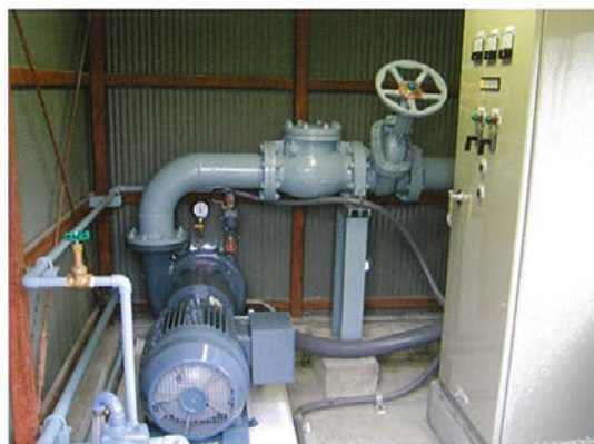
安馬谷揚水機場 H18
