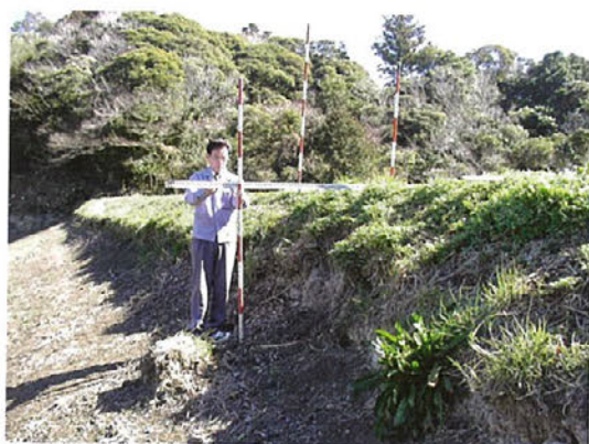
浸食され危険な堤体
