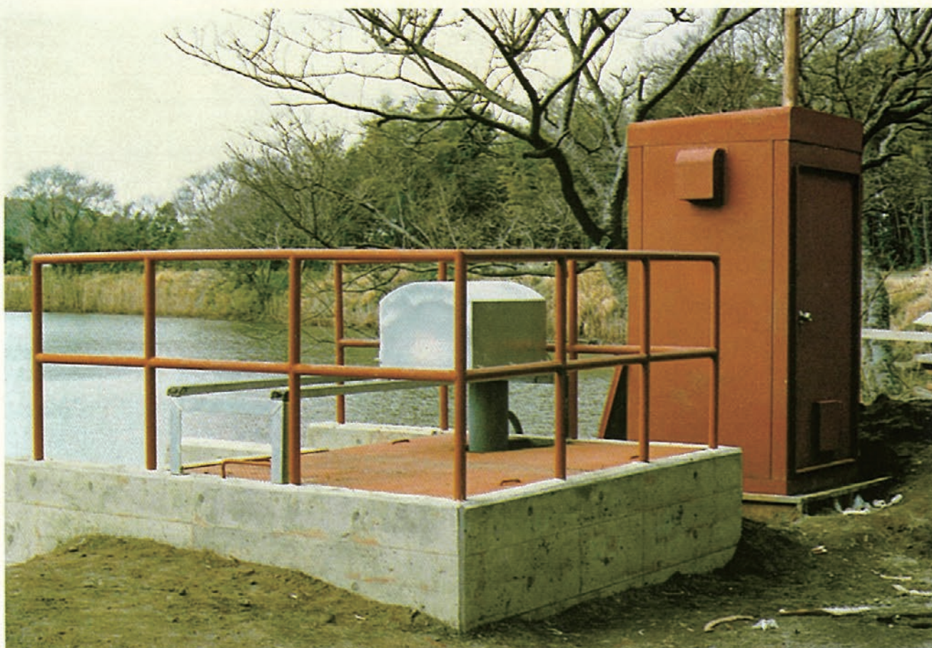
2幹末端用水監視装置及び分水工（山本堰）
